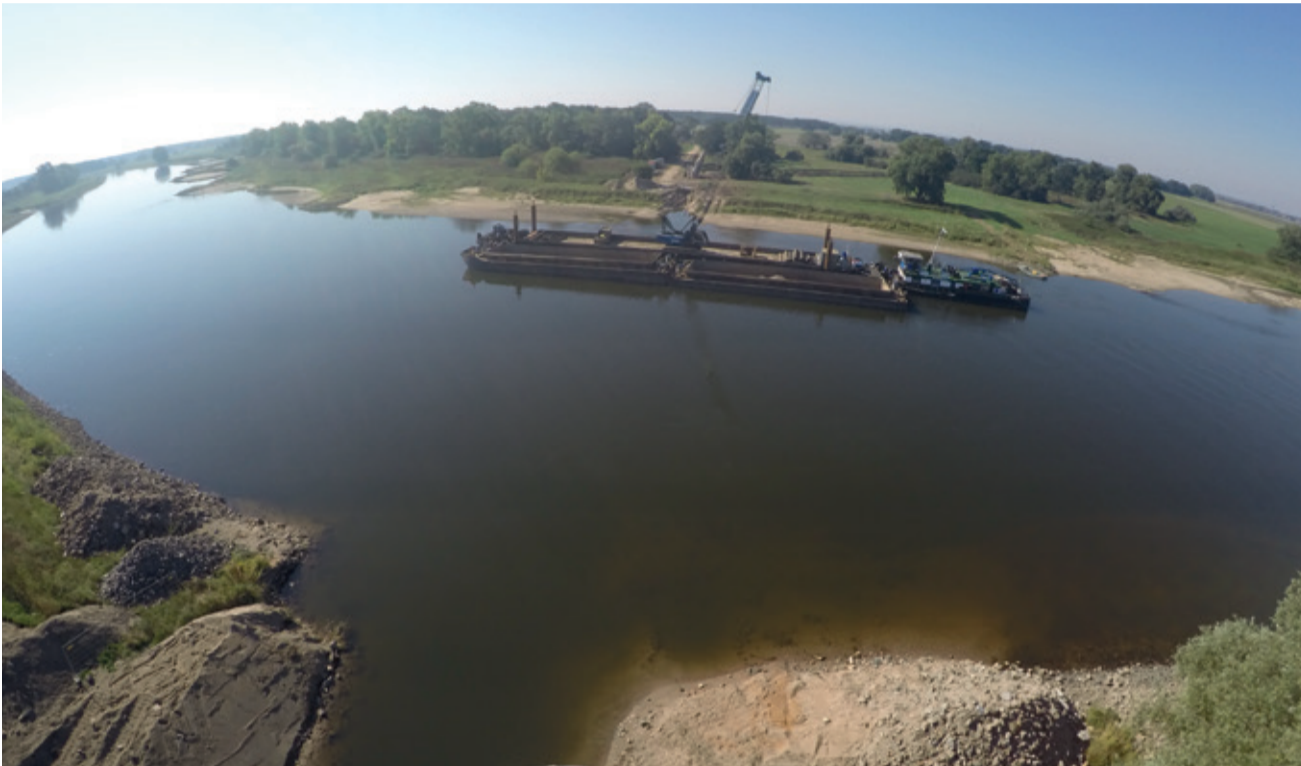
Mit dem Schwimmbagger wurde die Trasse für den neuen Düker auf die erforderliche Verlegetiefe gebracht.
