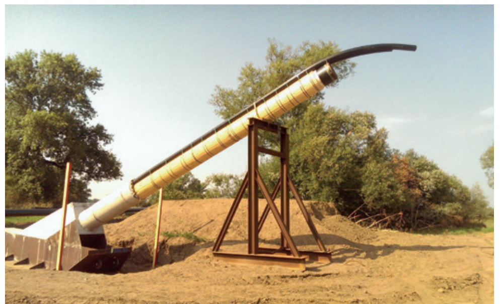
Dükerast mit aufliegenden PE-Rohren und Zugschlitten. (Foto: Bohlen & Doyen / PRT Berlin Brandenburg)
