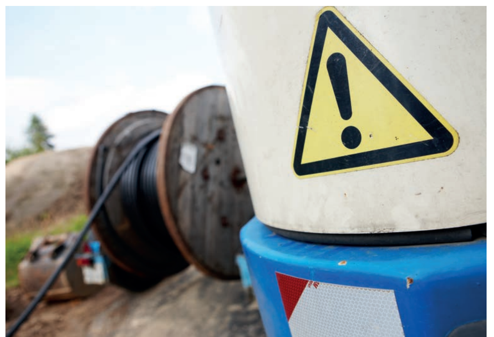
Das Erdkabel als neuer Standard – dahinter stehen noch einige Fragezeichen. (Foto: © fotolia | Christian Schwier)
